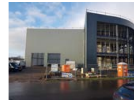
De ronding van de gevel vroeg om de nodige aandacht. Met name op detailniveau was het oppassen, zoals bij de koppeling tussen de ronde en de rechte delen. Maar dat is allemaal goed gekomen.
